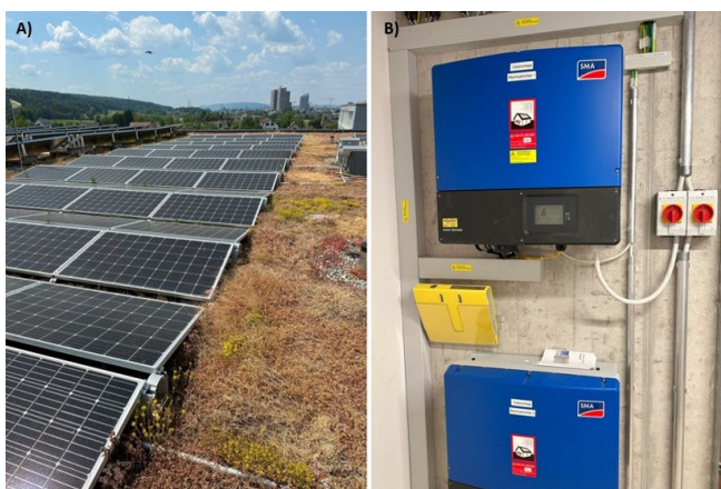
Abbildung 7: Solarsystem Alterszentrum IMWIL A) Photovoltaikanlage mit thermischer Solaranlage im Hintergrund auf dem Neubau des Alterszentrums, B) Wechselrichter für Photovoltaikanlage Quelle: Bilder von Yannick Meister
