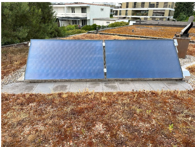
Abbildung 8: Kombination auf Einfamilienhaus von Herr Heiniger Quelle: Yannick Meister
