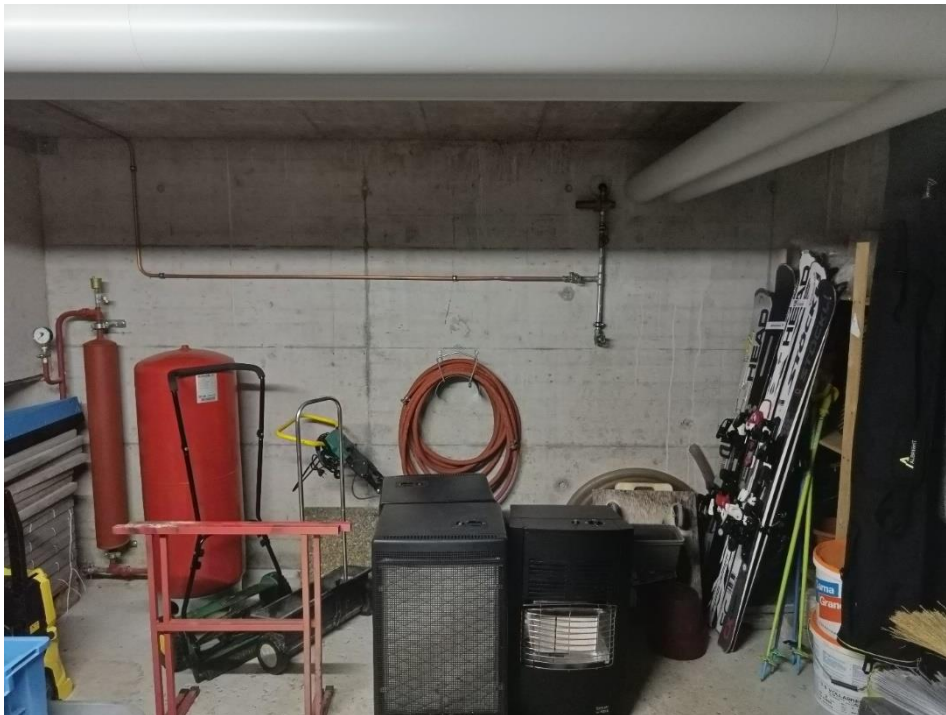
Abbildung 2: Einblick in den Heizungsraum inkl. den privaten Gegenständen
