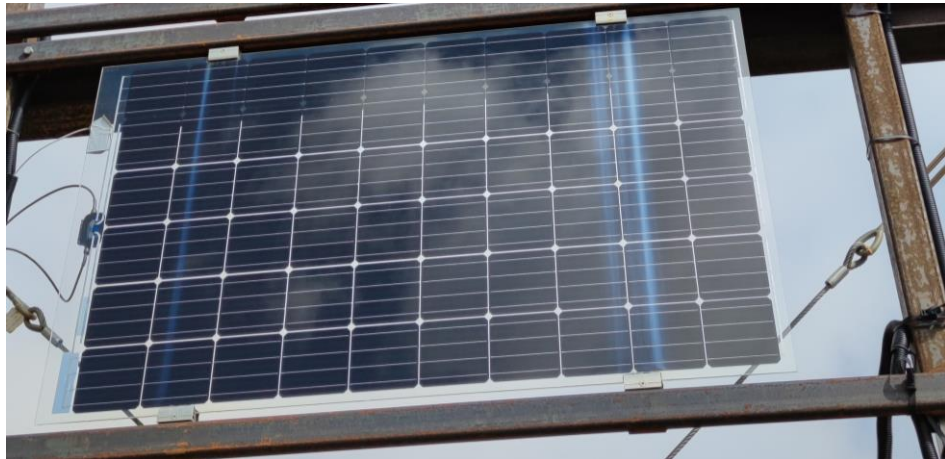
Abbildung 21: Ablagerungen auf den PV-Modulen im Segment 90° bifazial. Vermutlich entstanden durch eine Abtropfkante der Stahlkonstruktion und den Modulklemmen.
