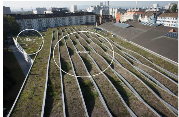
Abb. 11 Übersicht über die beiden Bereiche "flach" und "Wellen" auf dem BVB-Tramdepotdach. Die gesamte Dachfläche beträgt rund 8000m 2 , wobei in jedem Bereich zehn Fallen installiert wurden.
